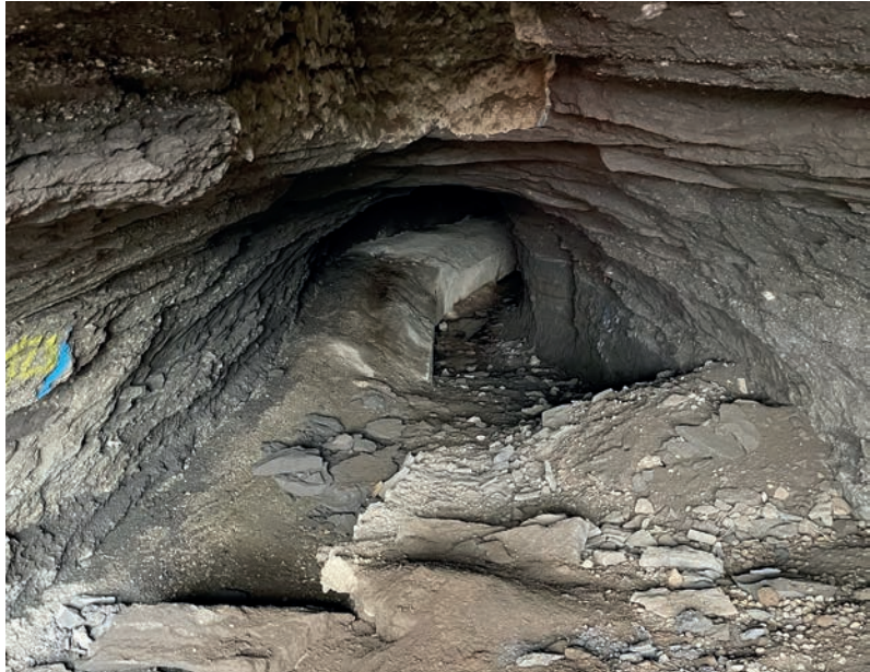
Nordwestende des Stollens im Bereich der vulkanischen Tephra im März 2022. Hier kam es zu Verbrüchen und der Stollen war hier verschlossen. Das Wasser wurde über ein Rohr abgeleitet. In diesem Abschnitt musste ein Spritzbetonausbau eingebracht werden.
