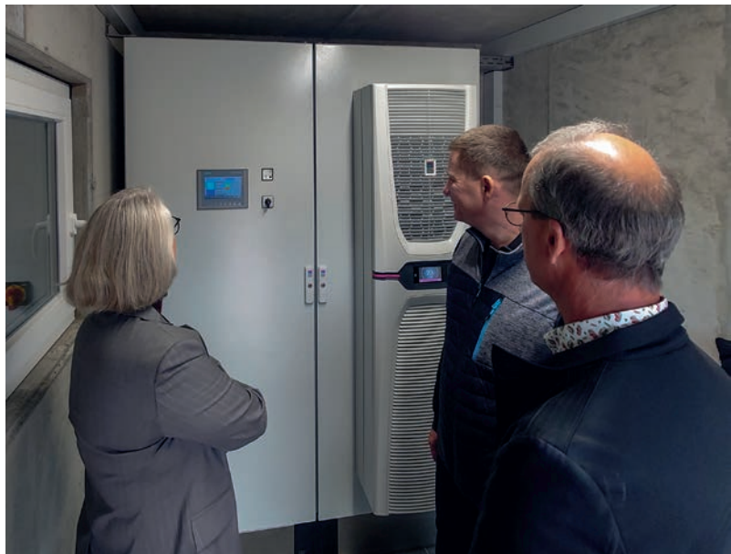
Alles in Ordnung: Im Steuerraum überzeugt sich Ortsbürgermeisterin Barbara Sand von der einwandfreien Funktion des Brunnens Laubenheim.
