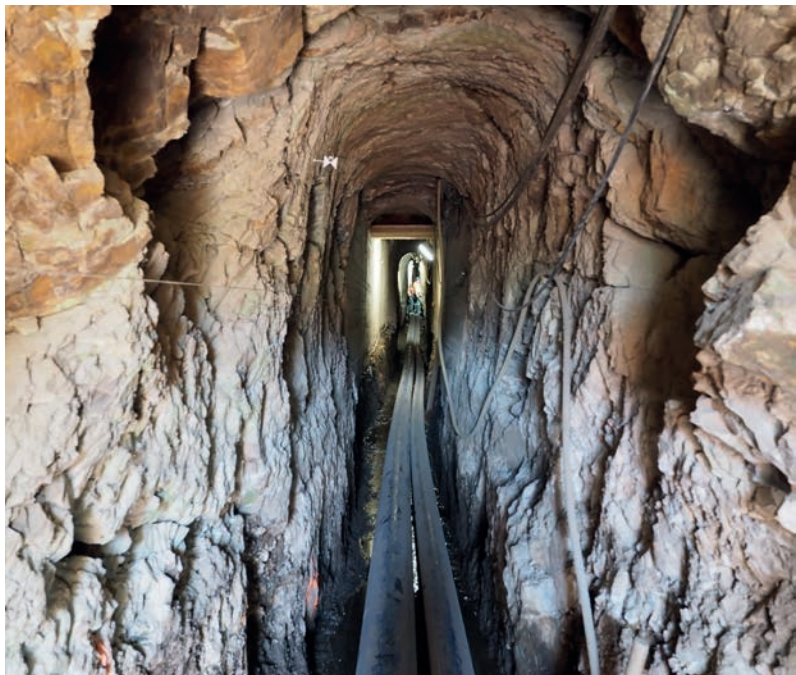
Stollen im Bereich der devonischen Ton- und Schluffsteine im Juli 2022 (Blick nach Südost). Durch die Wasserschläuche wurde auch während der Bauzeit das Wasser vom Jungferweiher in das Ulmener Maar abgeleitet.
