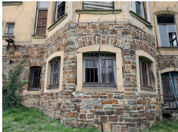
Prüfung einer denkmalgeschützten historischen Villa am Mittelrhein im Auftrag der GDKE. Die extremen Risschäden sind die Folge einer unzureichenden Gründung im Hanggelände bei „schwachem“ Baugrund.
