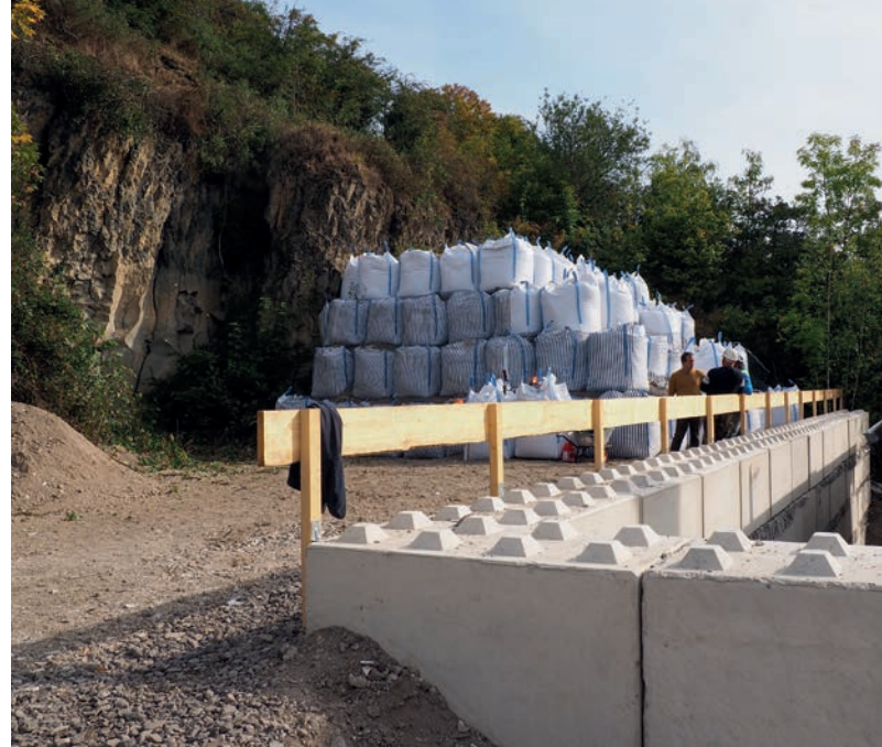
Bauzeitliche Stabilisierung der Felswand mit Betonblocksteinen und Big Bags zwecks Arbeitsschutz und Sicherung des Wohnhauses (September 2021). Die Big Bags wurden mit fortschreitender Sicherung etappenweise rückgebaut.
