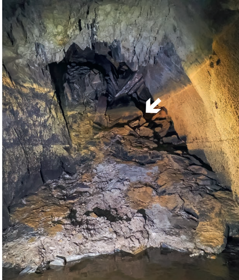
Vollständiger Firstbruch bei Station 500 m mit Wasseraustritt (Pfeil) auf etwa 2/3 der lichten Stollenhöhe.
