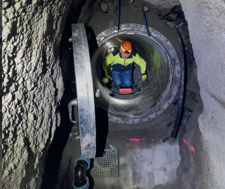
Drucktür zum Verschluss des Mannrohrs im Wasserdamm.
