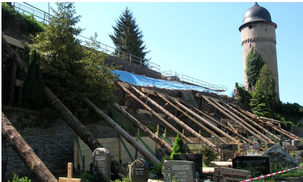
Abb. 2: Provisorische Abstützung einer durch Rutschmassen einsturzgefährdeten Mauer
