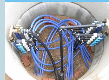
Erdwärmesondenkopf mit Anschlüssen
